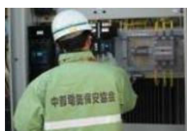
電気設備点検
